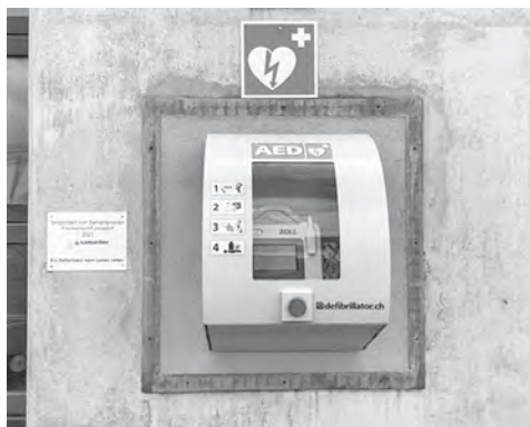
Defibrillator an der Fassade des Feuerwehrmagazins
