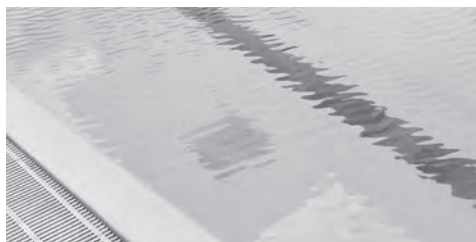
Fest installiertes Schwimmbecken
